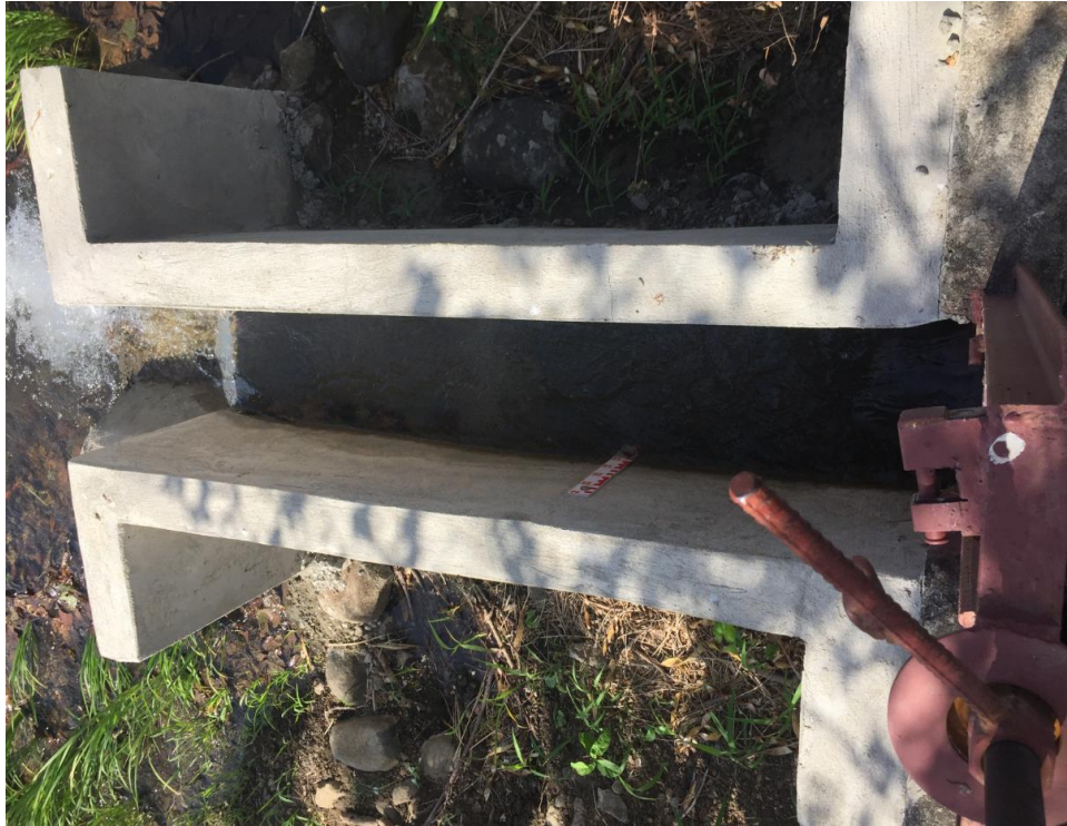
Ilustración 4 32. Estructura de aforo para toma de parcela utilizado en el DRAT
